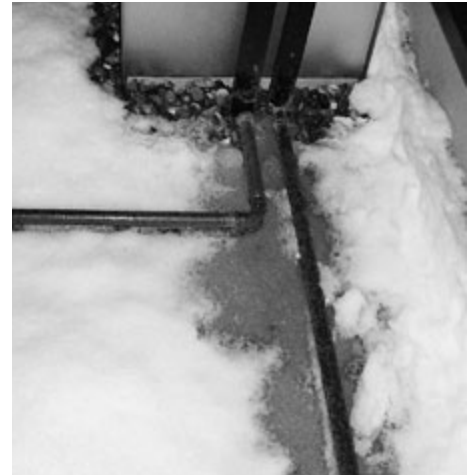
Mangel: Die Solarleitungen auf dem Dach einer Wohnanlage sind nicht gedämmt.
