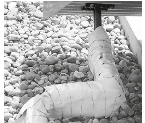
Mangelhafte Reparatur einer Solarleitung
