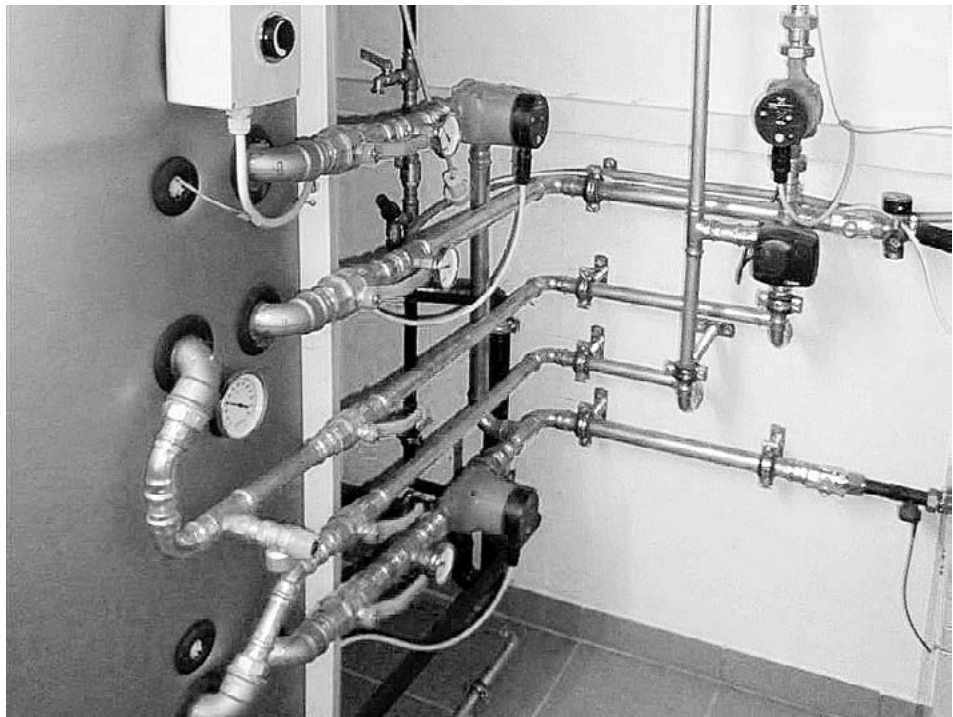
Fehlende Dämmung der Rohrleitungen
